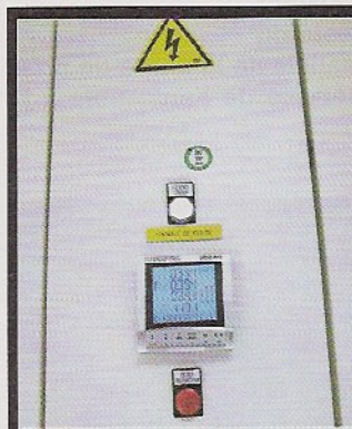
Figure 7 : Une des armoires électriques avec son indispensable gros bouton rouge \o/ Le compteur électronique indique que la consommation s'élève à 113KW, ce qui semble correspondre à l'alimentation des ordinateurs vectoriels. (photo : Laura)
