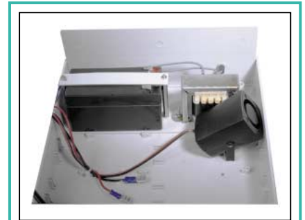
Figure 4 : La tension d'alimentation du circuit est prélevée du 220 volts à travers le transformateur TS1. Au secondaire, on obtient, après redressement, filtrage et régulation une composante continue à 13,6 volts. Cette tension maintient également la charge de la batterie, "tampon" qui est prête à intervenir dans le cas d'une coupure secteur.
